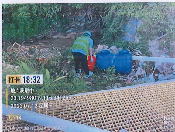
CN14 化粪池出水口
