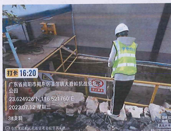
3#支洞生产废水
